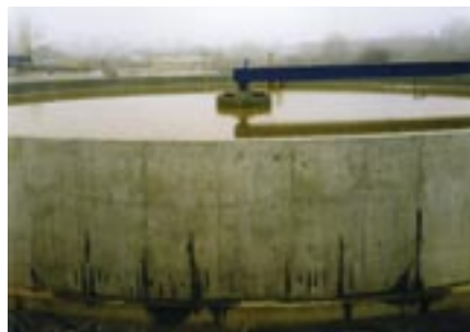
Fot. 1 Widok przeciekającej ściany zbiornika w wyniku jej wczesnego porysowania
