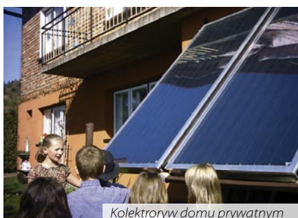
Kolektory w domu prywatnym
